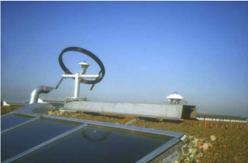
Abbildung 6: Wetterstation. Pyranometer mit und ohne Schattenring zur Bestimmung der diffusen bzw. globalen solaren Strahlungsintensität.
